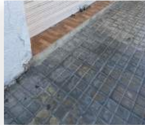
Plaza de la Concordia: Aceras desgastadas y en mal estado.
