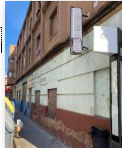
Locales inactivos con imagen descuidada.
