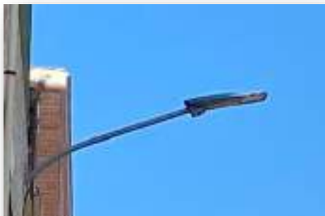
Farolas nuevas tipo led en buen estado a la altura un 1º piso.
